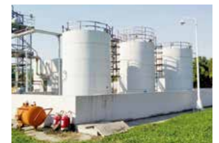
タンクヤード
